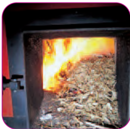
Chaudière à bois
